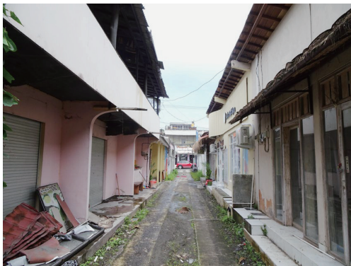
写真4-8 閉鎖し荒れた状態の店舗跡
